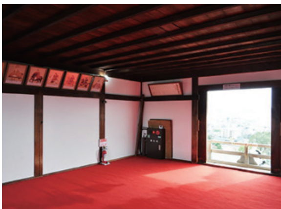
図5.3 四階の屋内消火栓と消火器
