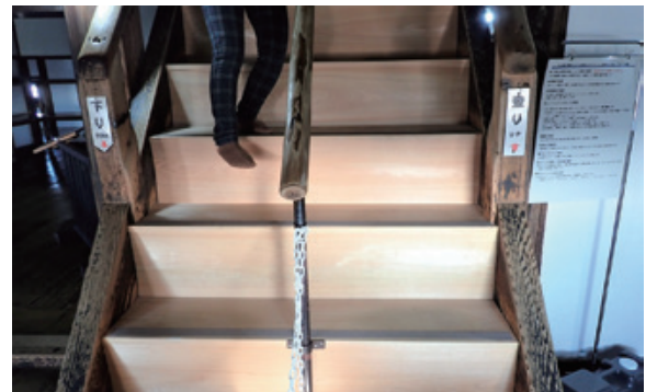
図5.12 階段の段差が大きく、転倒事故の危険性がある
