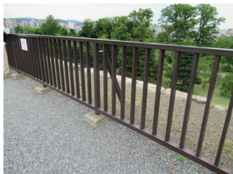
写真 6.55 櫓台の転落防止柵（史跡旧二条離宮）
