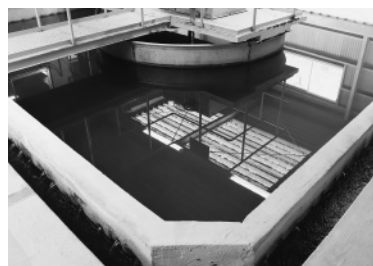
▲ごみなどを沈める沈殿池
