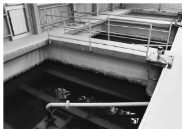
▲白山浄水場にあるろ過池
