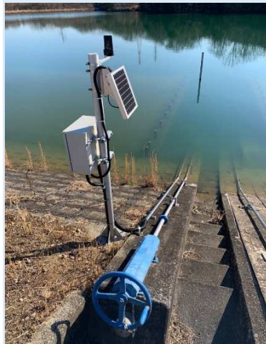
ため池水位計（新池：塔野地地区）
