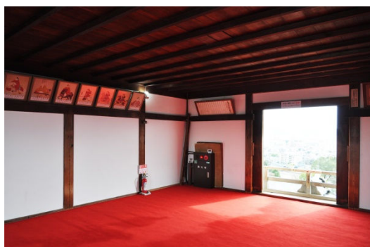
図 5.3 四階の屋内消火栓と消火器
