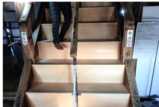
図 5.12 階段の段差が大きく、転倒事故の危険性がある
