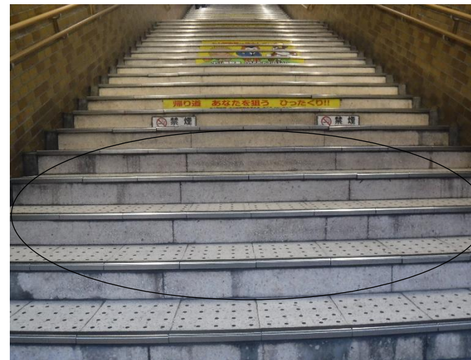
(23) 【西北】 踏板部分
