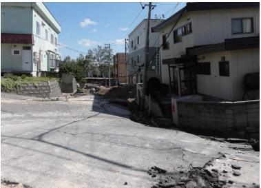
▲地震による道路の陥没(平成30年北海道胆振東部地震) (出典:一般財団法人消防防災科学センター)
