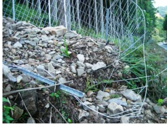
破損した柵は補修が必要
