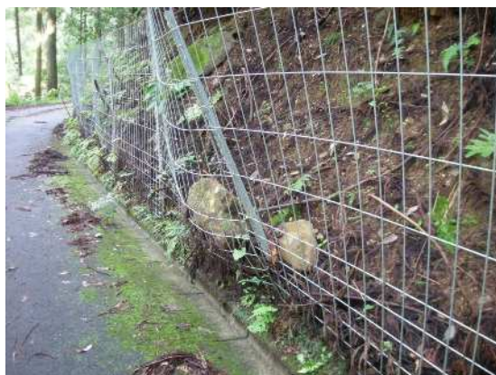
ワイヤーメッシュ柵は破損すること多い
