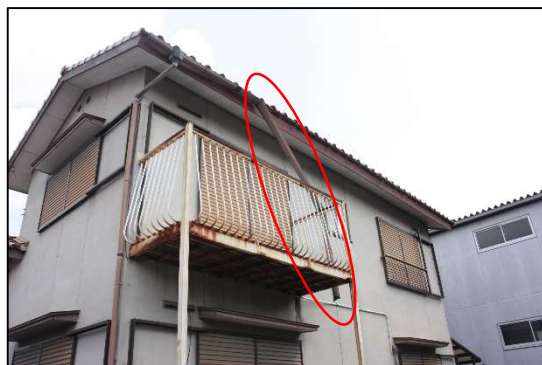
雨樋の固定が外れ脱落、飛散の恐れ
