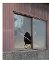
窓が割れた 管理不全空家
