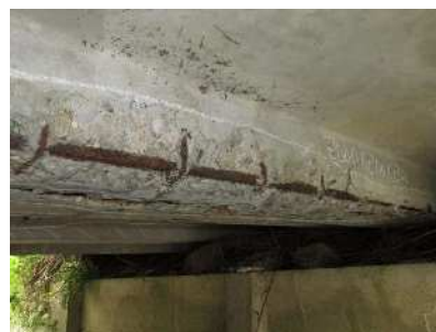
写真-1.1 橋梁の損傷事例
