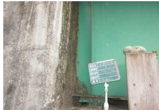
写真-4.1 上部工の損傷状況（腐食）
