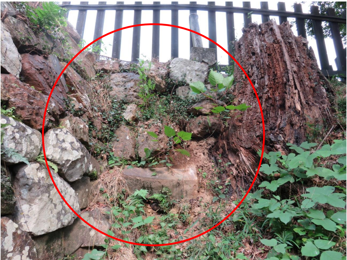
【拡大】弓矢櫓跡南側石垣崩落後（令和4年9月下旬）
