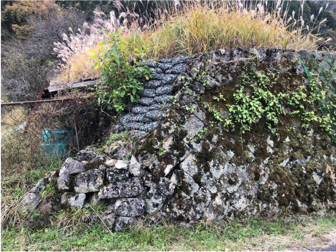
碎石土嚢による崩落防止の事例（兵庫県佐用郡佐用町 利神城）
