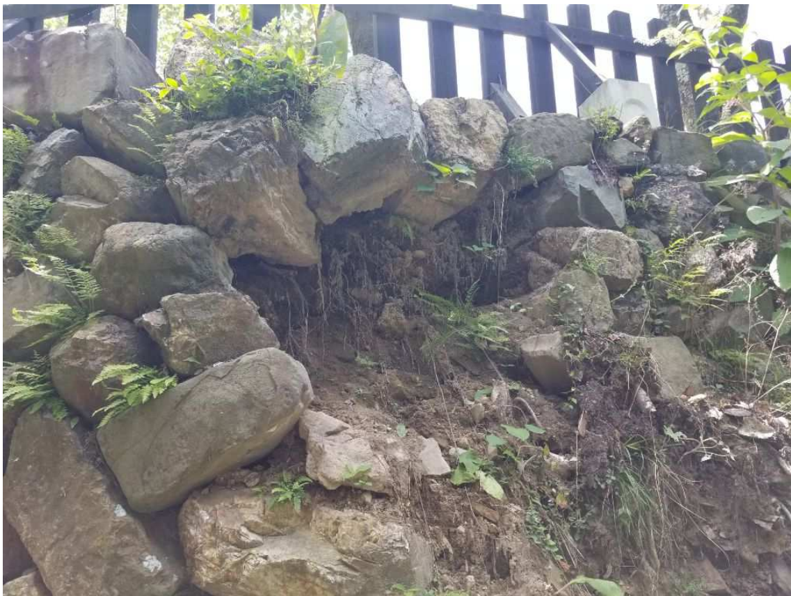
石垣崩落状況（北から）
