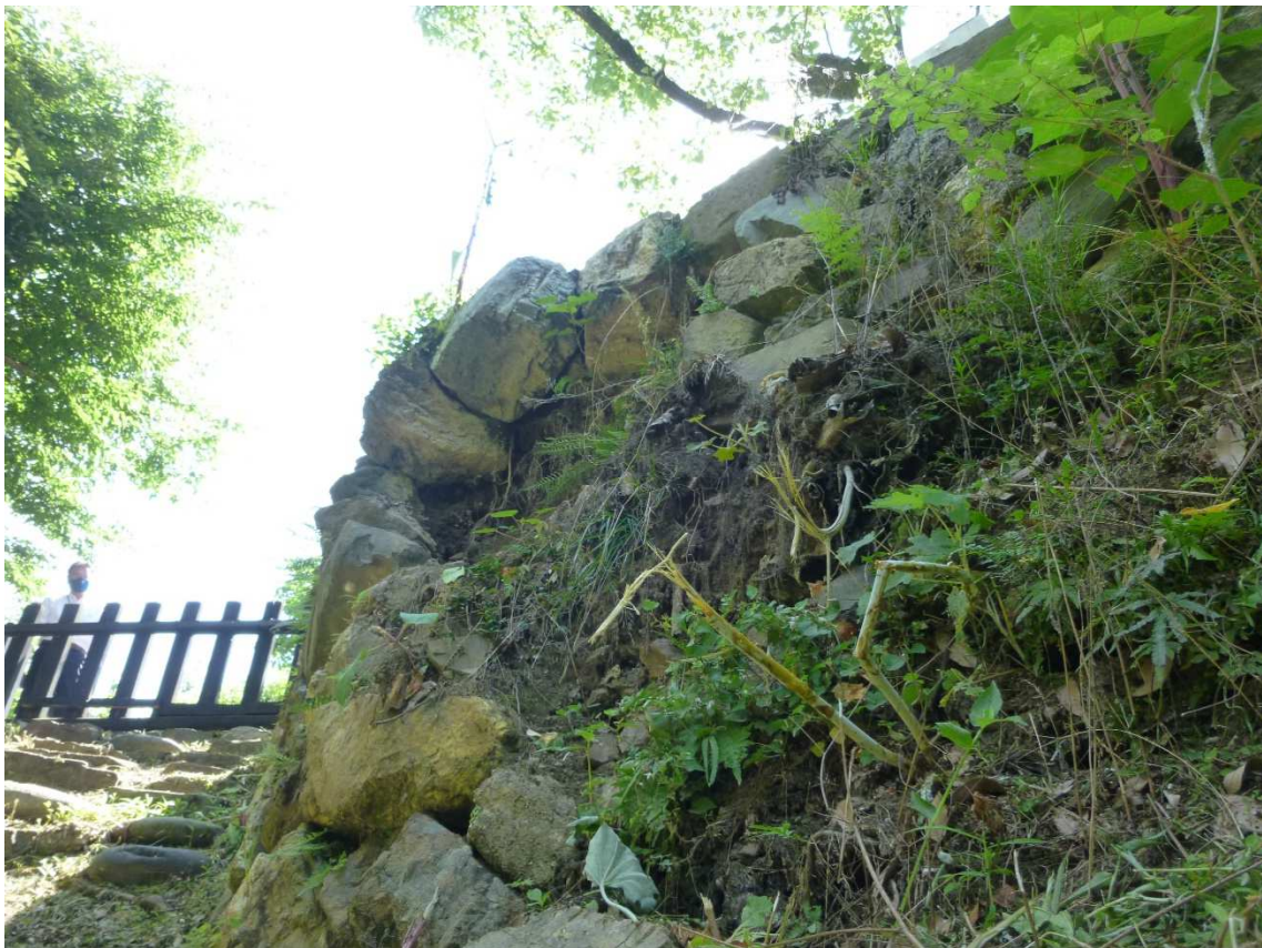
石垣崩落状況（西から）
