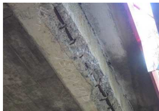
写真-4.2 上部工の損傷状況（剥離・鉄筋露出）
