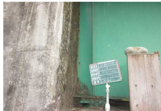
写真-4.1 上部工の損傷状況（腐食）
