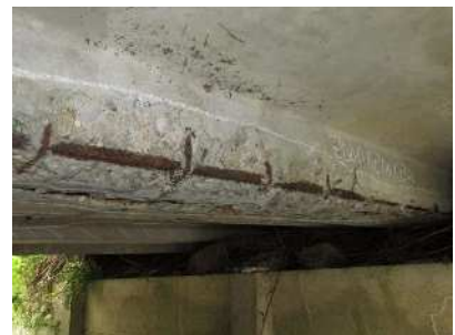
写真-1.1 橋梁の損傷事例
